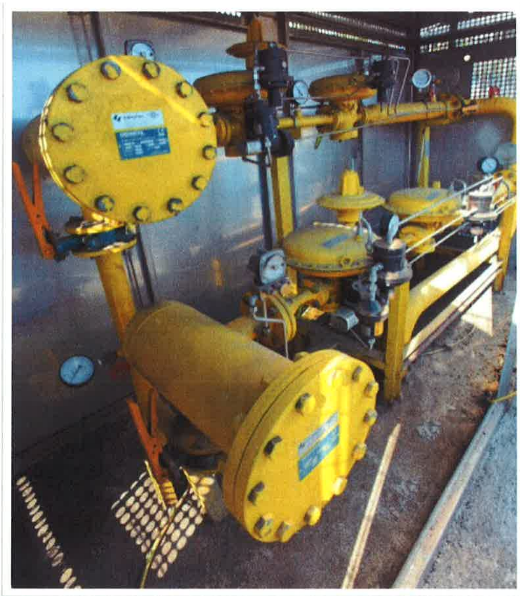
Giarre – Cabina di Decompressione
